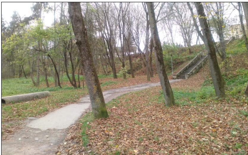
Рис. 27. Зсувонебезпечна ділянка на правому березі р. Серет в гирлі балки на вул. Миру
