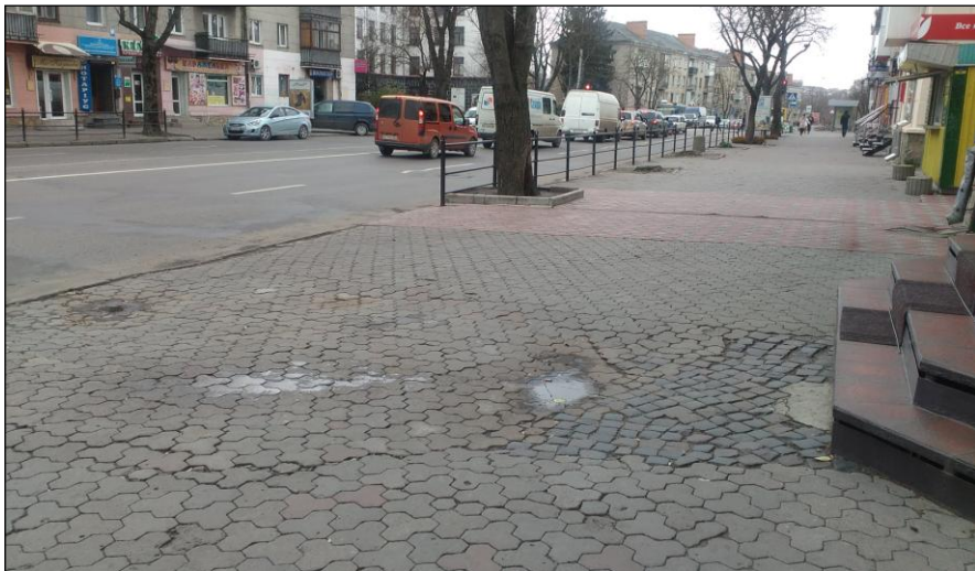
Рис. 24. Просадка на тротуарі (вул. Руська)
