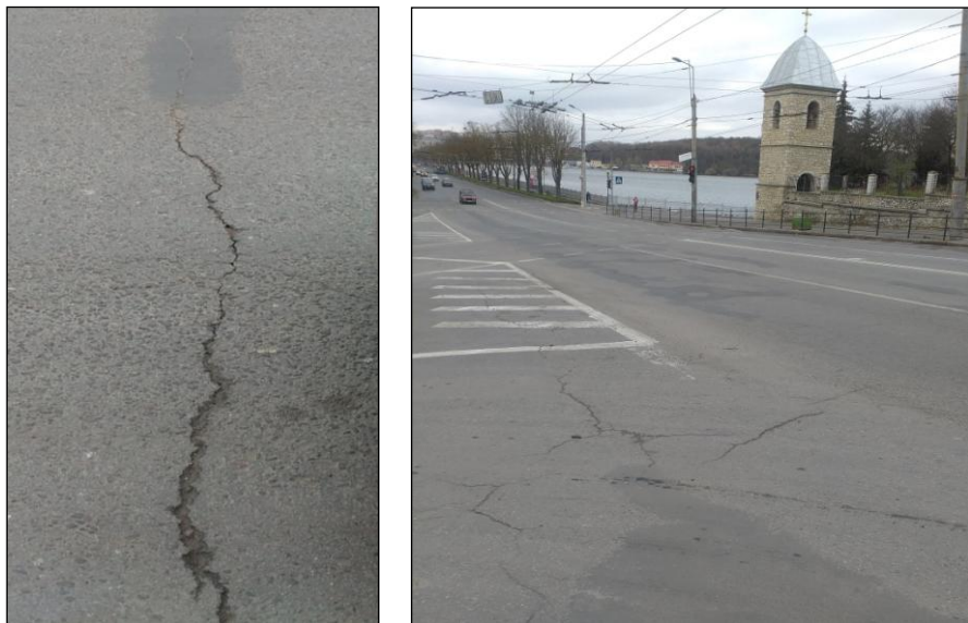
Рис. 23. Тріщини на асфальті (вул. Руська)
