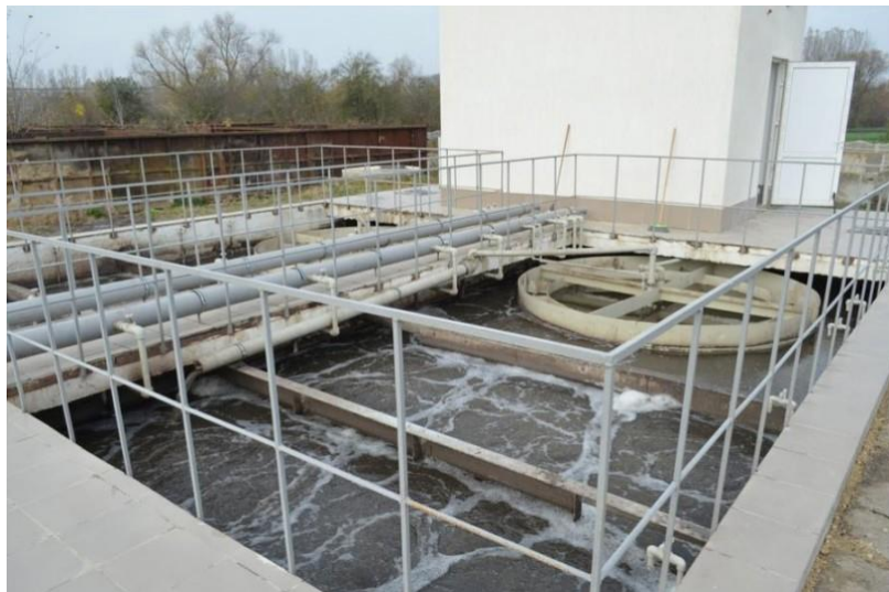
Рис. 3.1. Очисні споруди у міста Ланівці [20]
