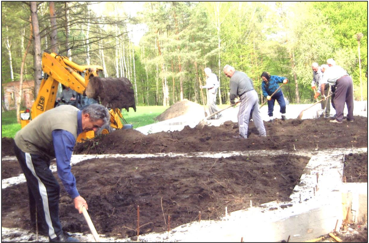
На завершувальних роботах по закладенню фундаменту під лемківську церкву. На передньому плані — І. М. Тройчак. На задньому плані — голова церковного комітету І. С. Фалатович із колегами, які вирівнюють землю за висотою фундаменту
