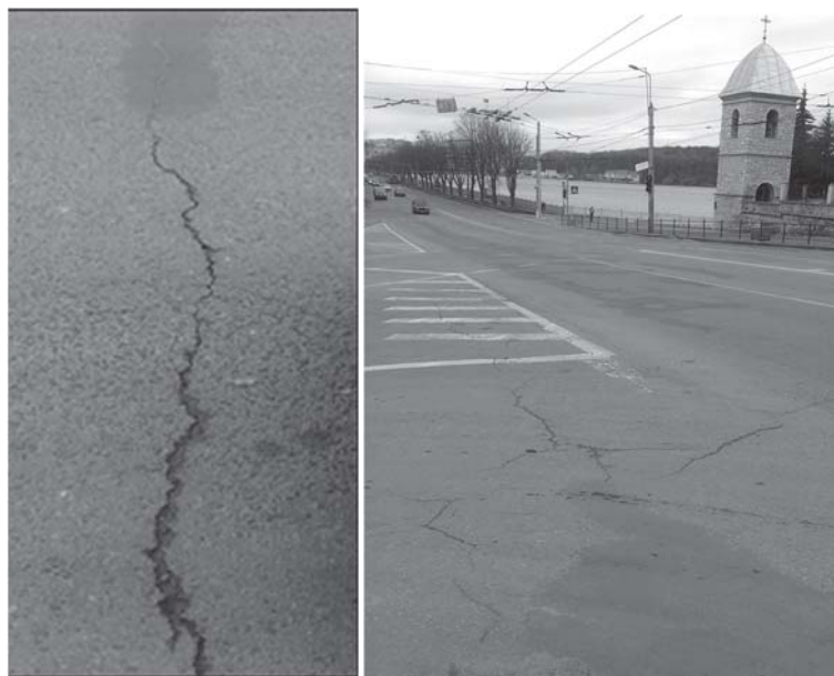
Рис. 3. Тріщини на асфальті (вул. Руська)
