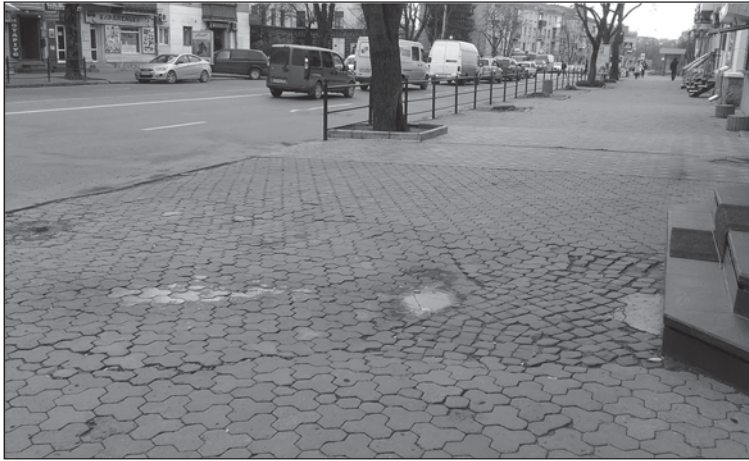
Рис. 4. Просадка на тротуарі (вул. Руська)
